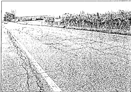
Il tratto di strada interessato
